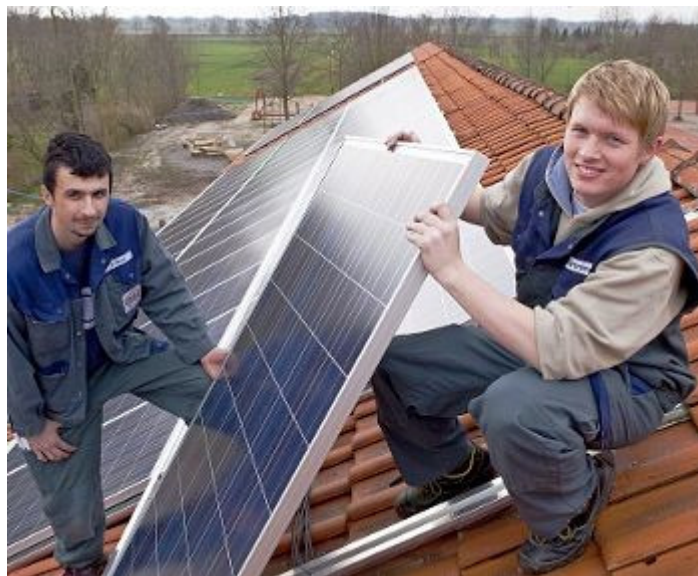
Denis Hartmann und Altan Bulut (links) von der Stader Firma NDB montieren Solaranlagen auf der Grundschule Hammah.
